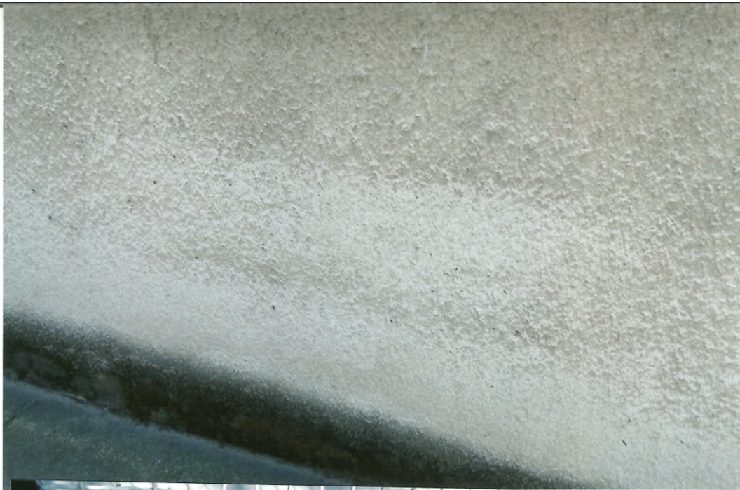
4. Wilgoć na ścianach budynku
