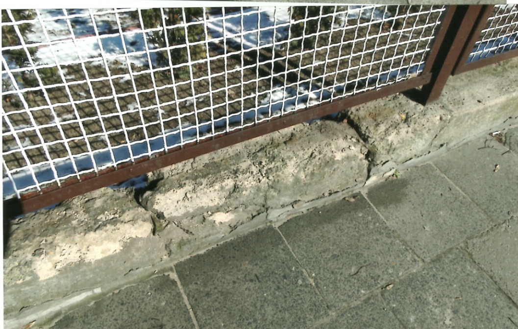
6. Uszkodzenia podmurówki płotu
