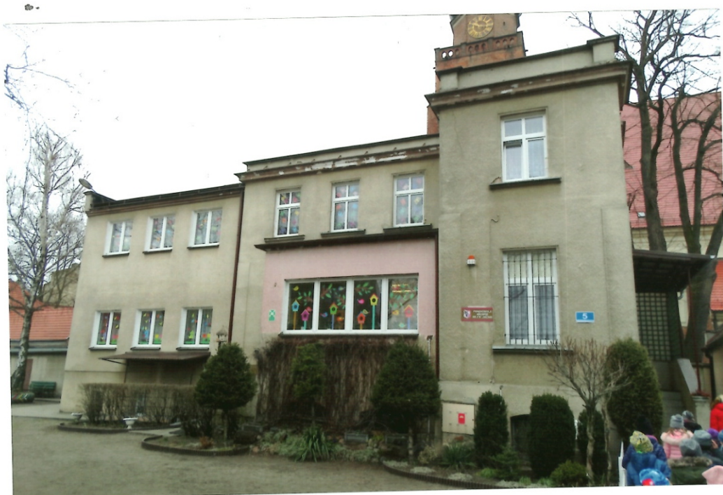
7. Zewnętrzna część elewacji z fragmentem usuniętych tynków (kolor różowy) w związku z dużą degradacją.
