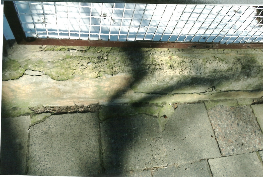
5. Uszkodzenia podmurówki płotu ogradzającego plac zabaw
