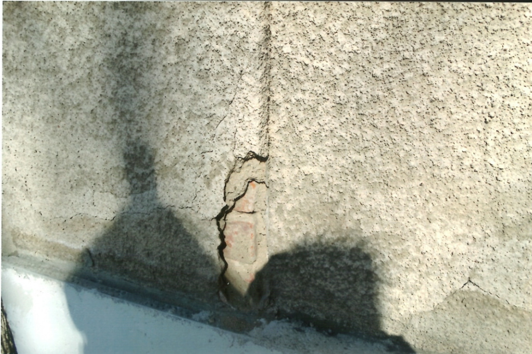
2. Uszkodzenie elewacji zewnętrznej budynku
